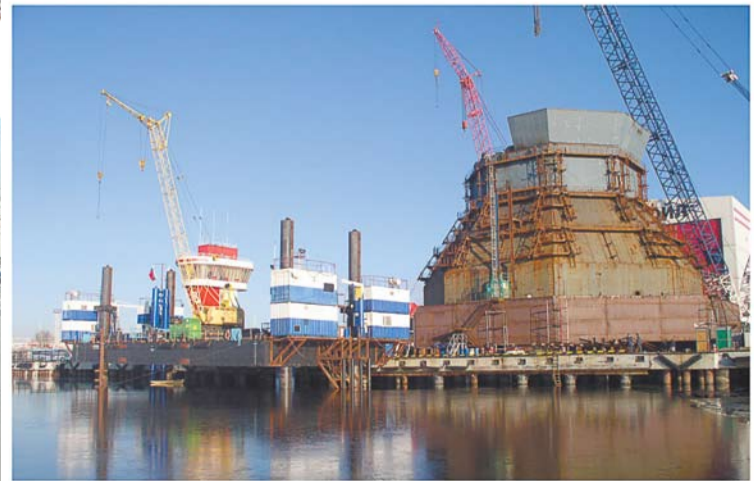
ЗАО «Трест Севзапморгидрострой». Возведение причальных сооружений многопрофильного перегрузочного комплекса «Юг-2» в морском торговом порту «Усть-Луга»
